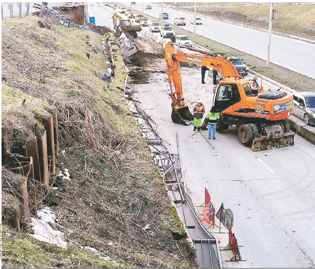
Подпорная стенка обвалилась глубокой ночью.
